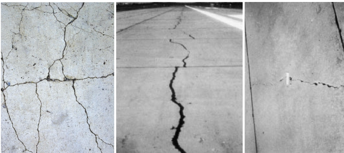
мал. 1 Приклад наскрізних тріщин
