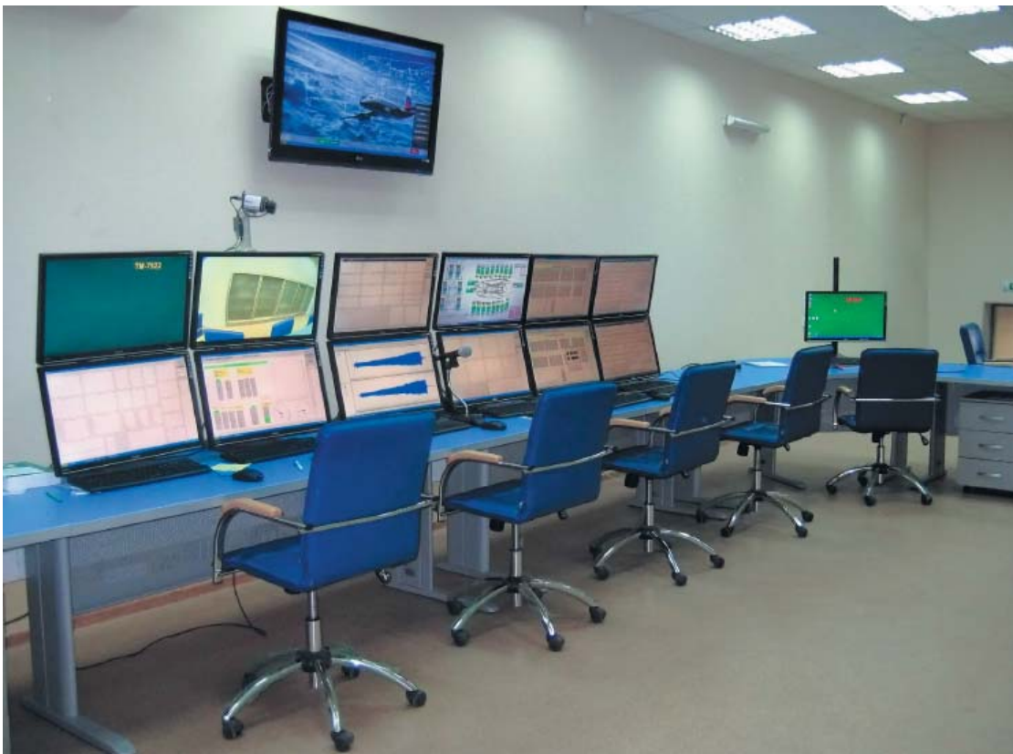
Рисунок 2.2 - Пульта з екранами САК ВС, системи вібраційного контролю і діагностики, системи параметричної діагностики, засобами ручного контролю та перемикачами
