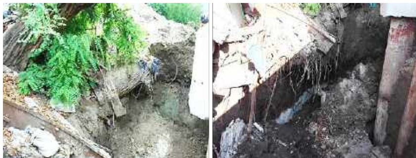
Рисунок 14 — Зсув ґрунту на подвір'ї будинку, Андріївський узвіз, 16
