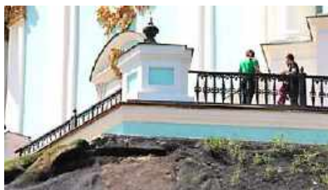
Рисунок 12 — Зсув ґрунту під оглядовим майданчиком Андріївської церкви
