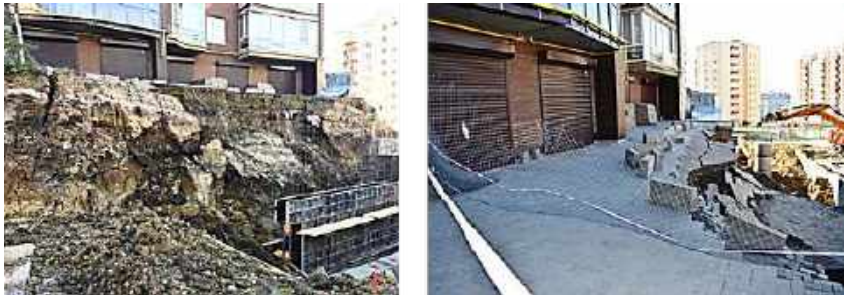
Рисунок 3 — Зсув ґрунту біля стін 11-поверхового будинку в Хмельницькому
