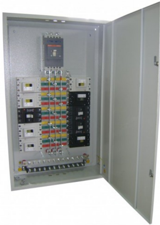
Рисунок 2.4 – Загальний вигляд силової розподільчої шафи
