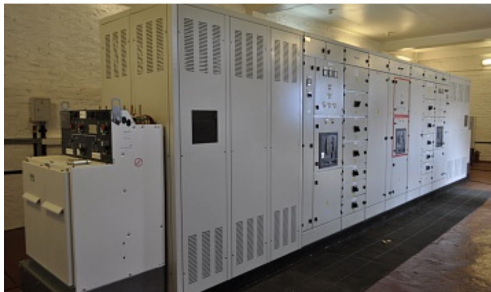
Рисунок 2.3 – Загальний вигляд силової шафи
