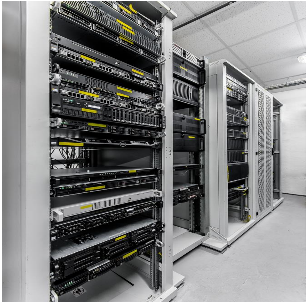
Рисунок 3.1 – Серверне приміщення ТОВ «kmb»
