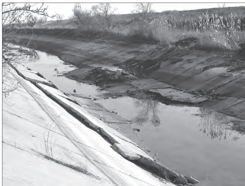
Фото 6.1. Руйнування силою гідростатичного тиску ґрунтових вод бетонного облицювання Північно-Кримського каналу на ділянці 357 ÷ 358 км
