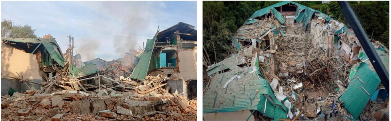
Рис.3.2. Зруйнована будівля РБК м. Чугуїв
