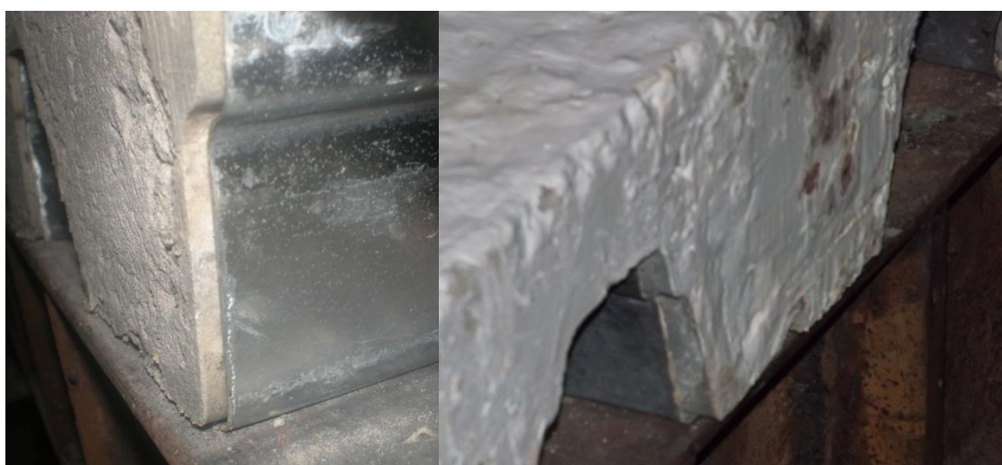
Рисунок 10.20 – Зміщення бетонного блоку відносно профнастилу
