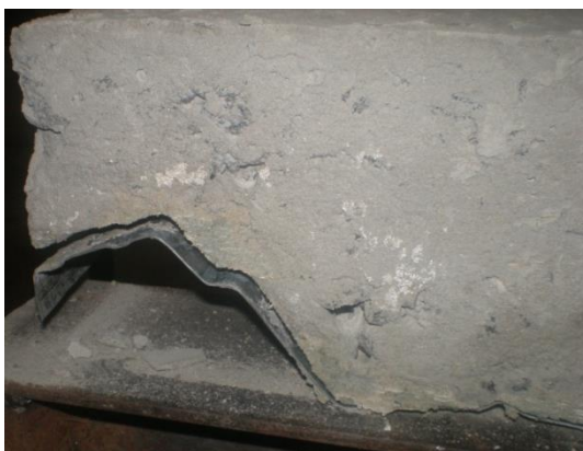
Рисунок 10.19 – Відшарування листової профільованої арматури в торці конструкції
