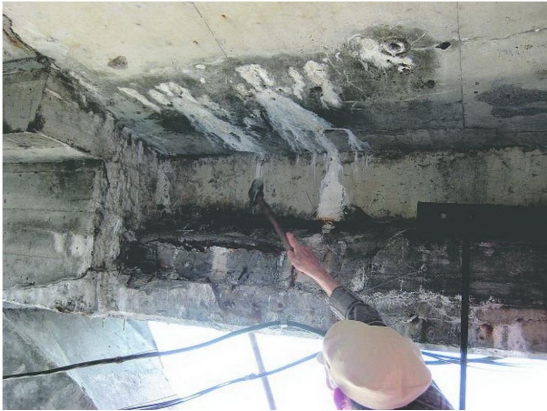
Мал. 1.2.1. Наслідки пожежі на залізобетонні конструкції.
