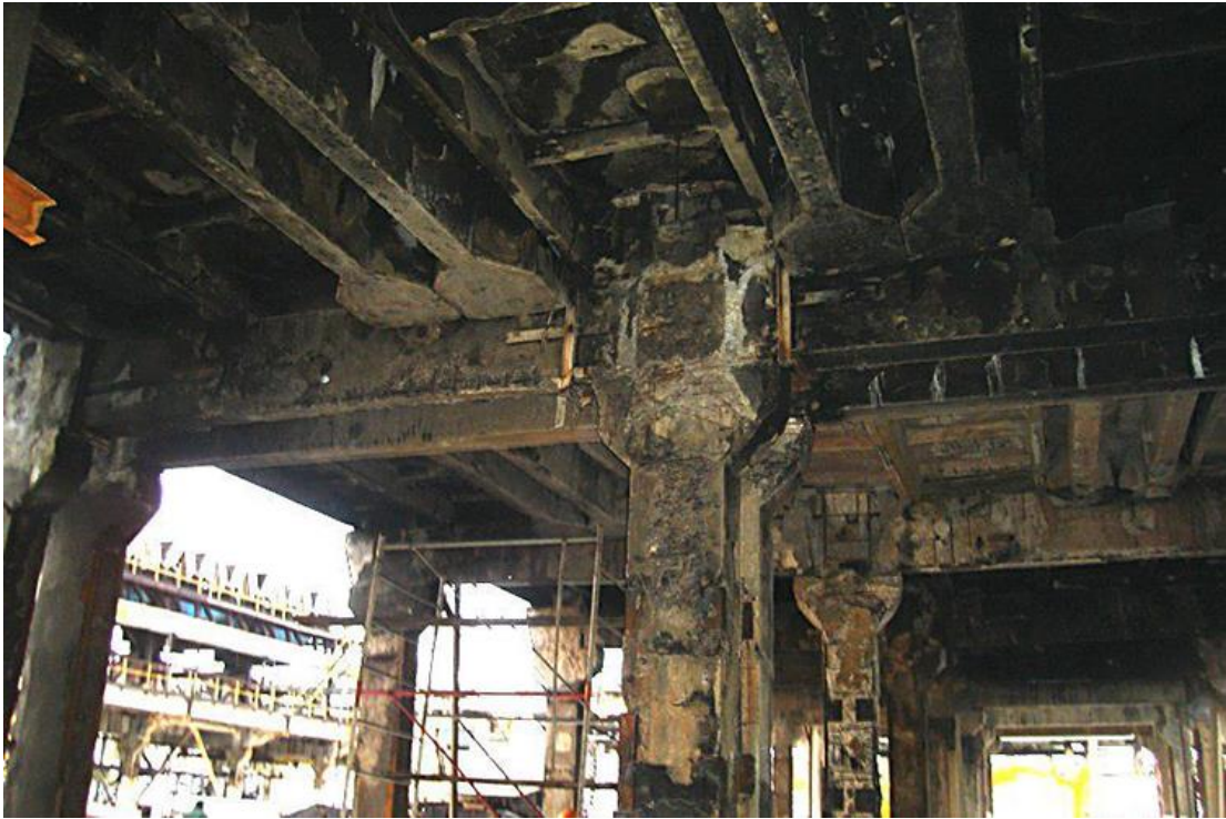
Мал.1.2.2 Приклад руйнування бетону після пожежі.
