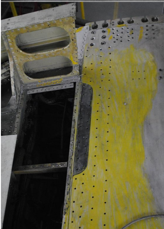
Множественные коррозионные повреждения панелей центроплана
