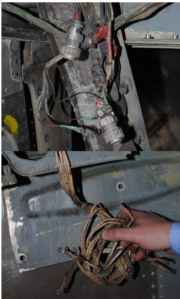
Левая мотогондола. Обрывы проводки, коррозия клеммных колодок, ШР-ов СПУТ
