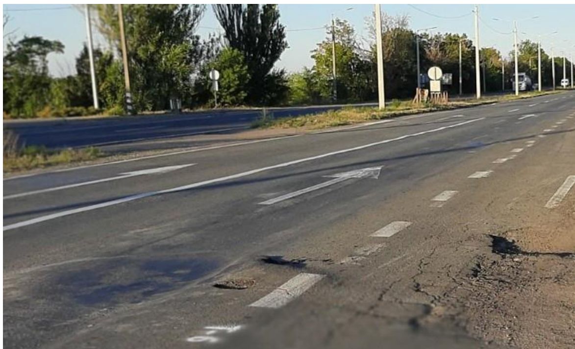
Рисунок 2.2 – Руйнування дорожнього покриття у вигляді сітки тріщин, колії та просідань
