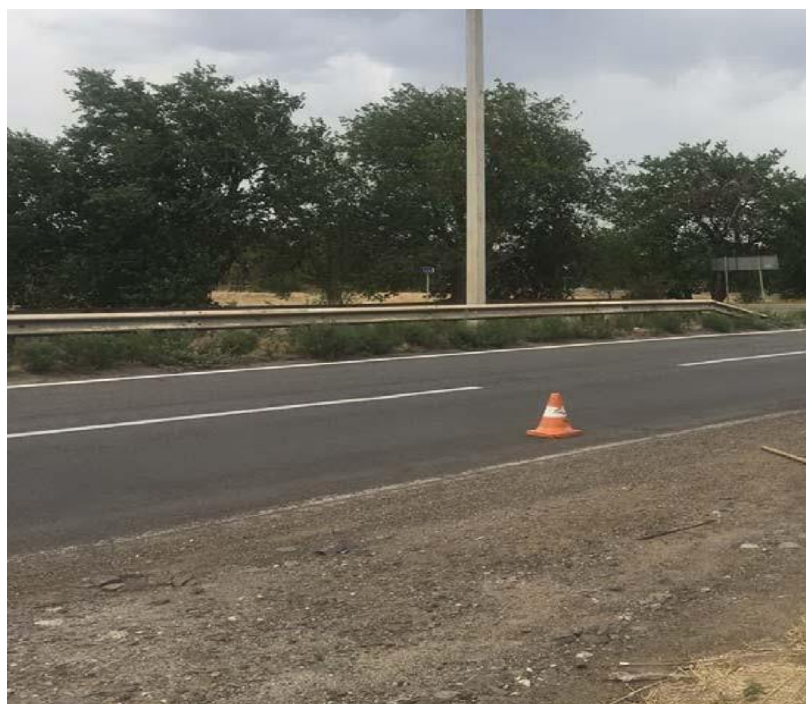
Рисунок 2.1 – Руйнування дорожнього покриття у вигляді викришування
