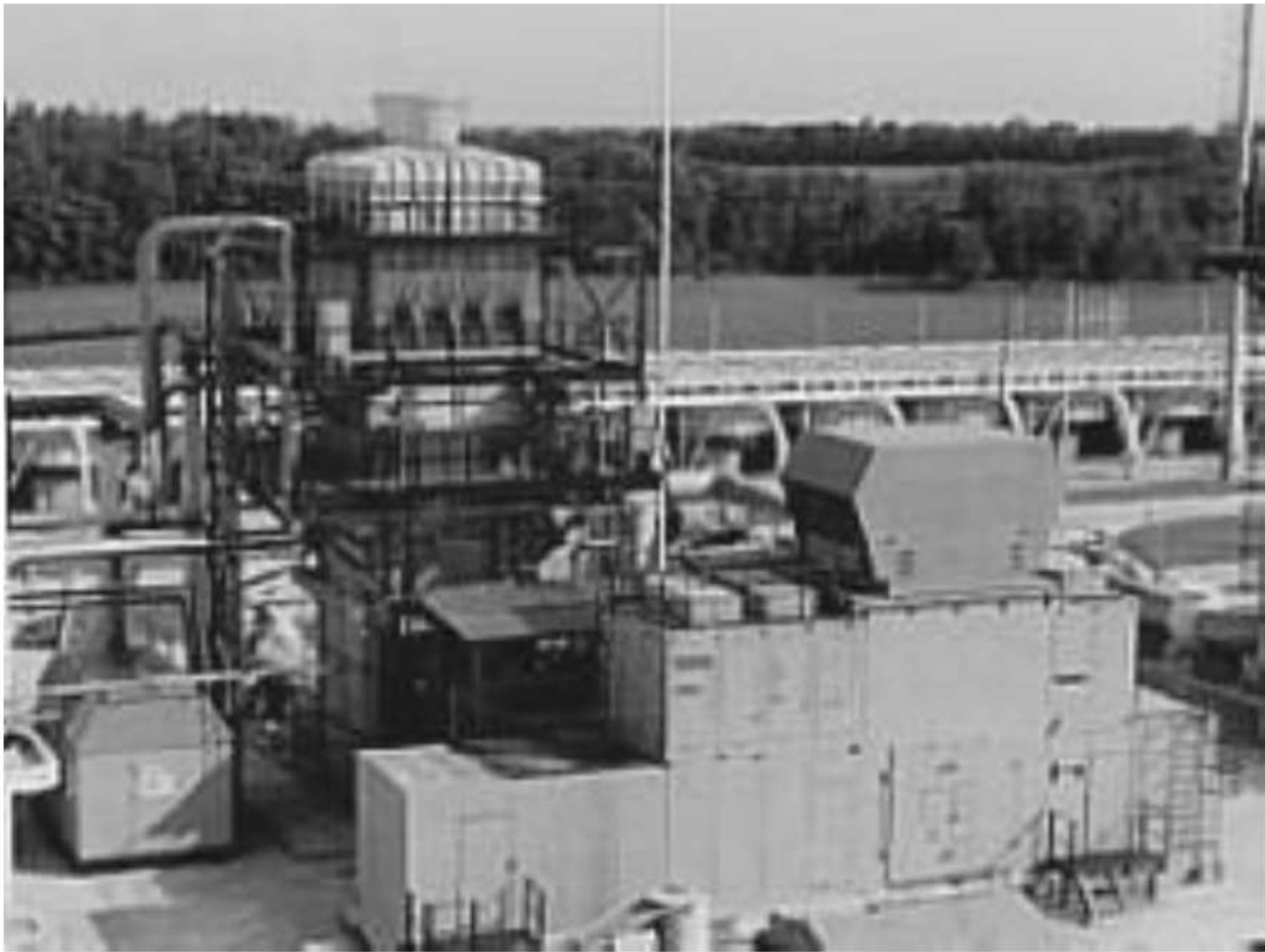
Рис.1.4. Газопарова установка «Водолій» на компресорній станції «Ставищенська»
