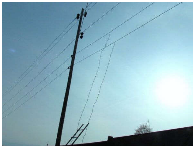
Рисунок 4.10 Крадіжка електроенергії з ЛЕП
