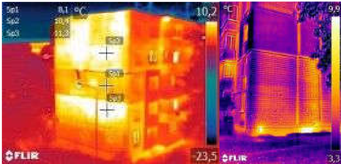
Рисунок 2.4-зправа і 2.5-зліва. Інфрачервона зйомка житлової будівлі
