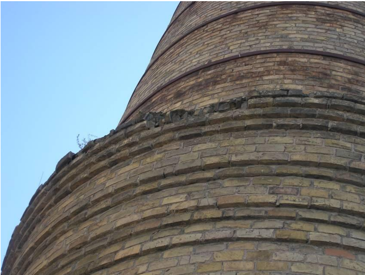
Рис. 1. Зруйнування цегляної кладки димової труби
